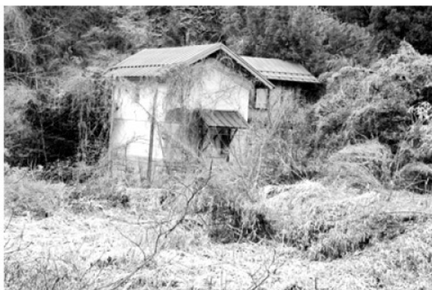
老朽化した空き家
